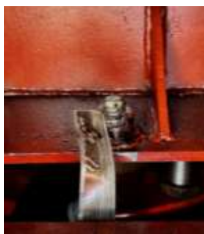
Рис.1. Обрыв заземляющей шинки ярма магнитопровода трансформатора
